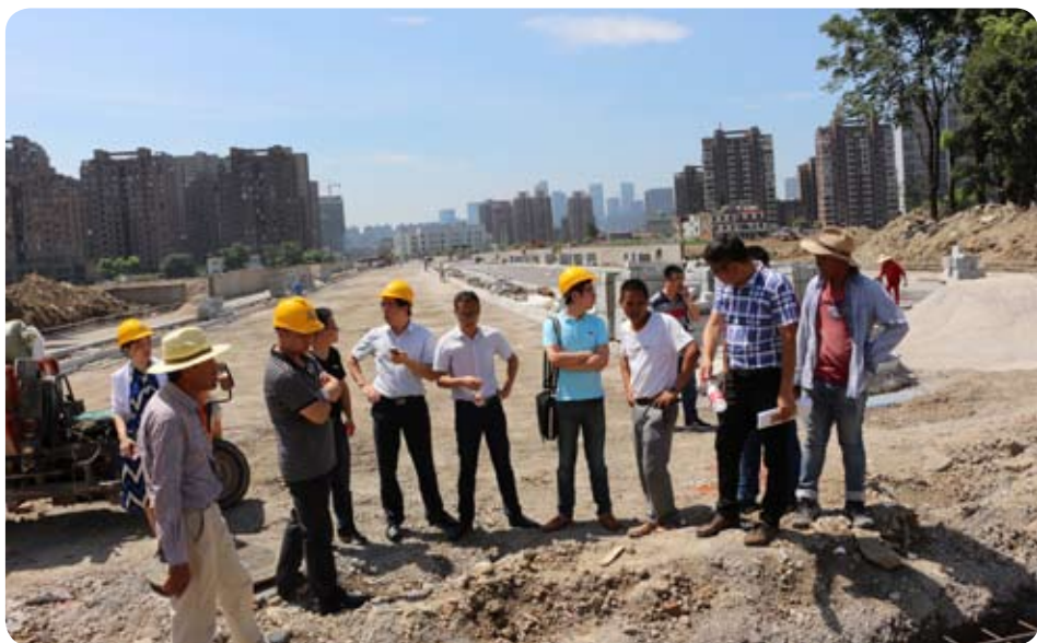
7月20日，公司副总胡卫率相关部门负责人检查重点工程建设进度，总经理助理张中勇陪同检查。胡卫副总一行先后检查了三新路（艮山西路—东农大路）、运河水陆交通集散服务中心项目，并在现场详细了解工程进度、质量管控、计划措施等情况。
